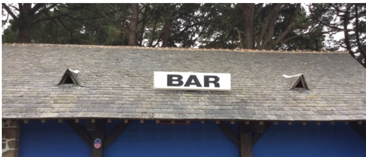
Enseigne sur toiture (illégal) car panneau plein, l'Île-aux-Moines, août 2019
